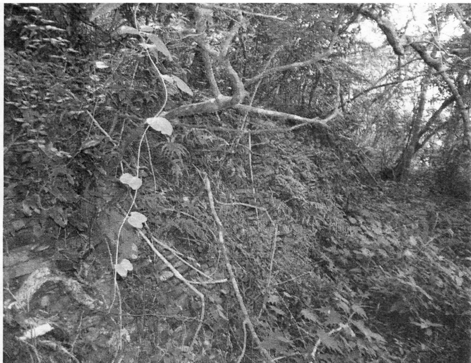
照片 13：日治時期修建之駁坎
