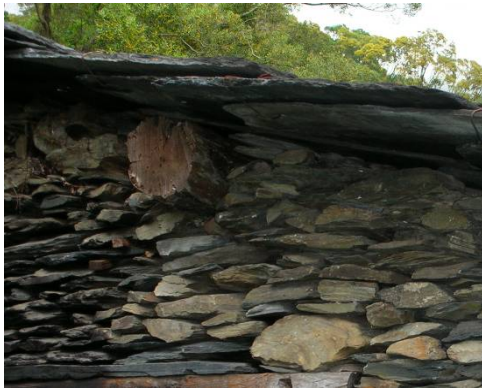
樑頭穿透石牆情形
